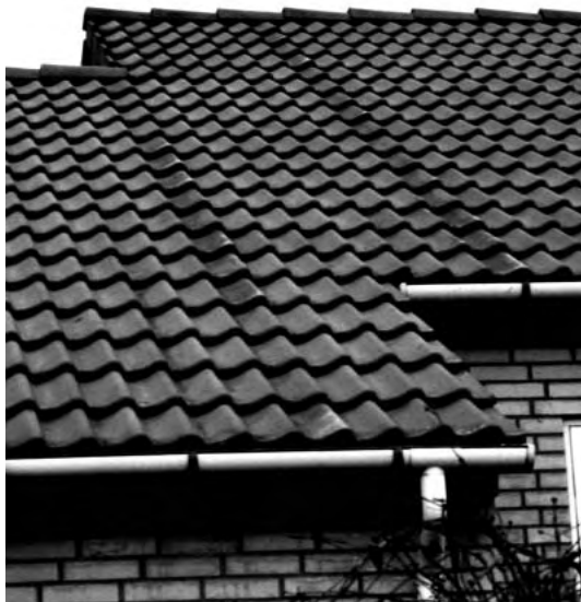
Figur 4 Tegltaget med de to mørke striber (markeret med pile)
